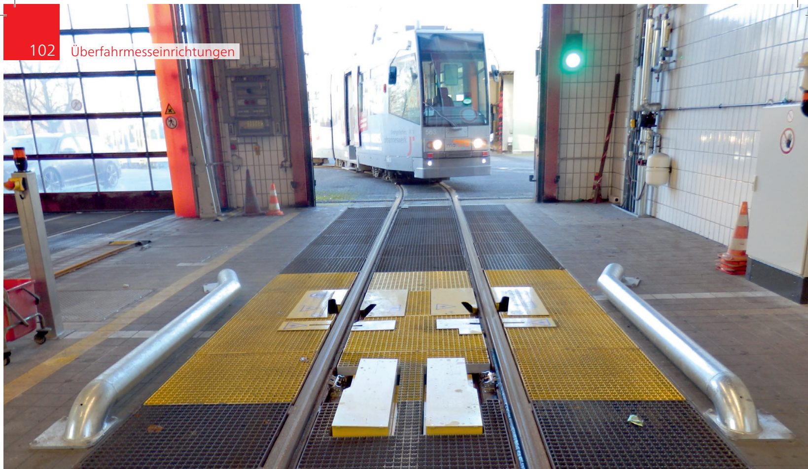
»IWMS« Indoor-Messanlage mit Überfahrmöglichkeit für Busse.
