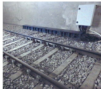
Flachstellen- und Polygonmessstelle im Gleis. Bild: DSW21
